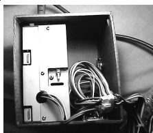
〈写真11〉中はほとんど電源が占めている。
